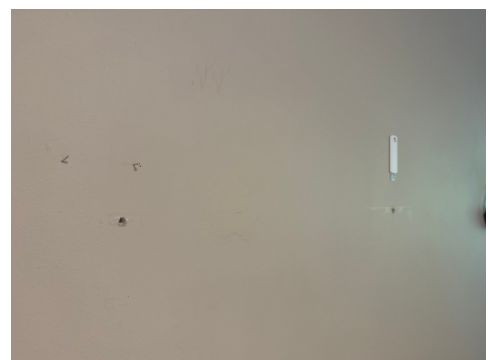
Skruehull etter innfesting av tv (forrige eier) på det store soverommet.
