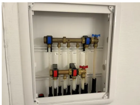
Fordelerskap til «rør i rør» vannforsyning
