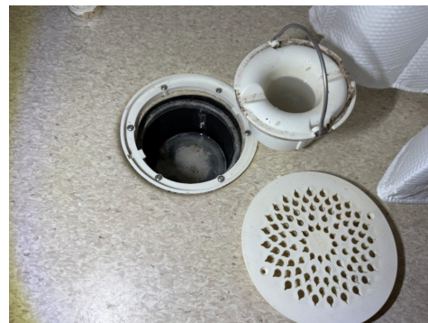
Sluk er plassert utenfor selve dusjsonen
