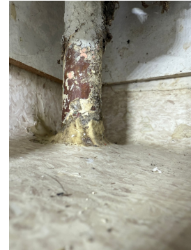
Gjennomføringer ved rør bak wc er ikke sveiset opp langs rør
