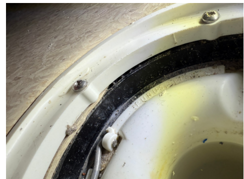
Vinylbeleggets avslutning rundt klemring er ikke fullstendig synlig rundt hele
