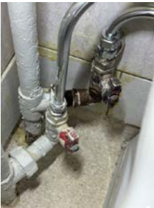
2 x stoppekraner bak wc på bad.
