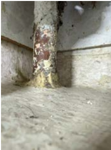
Gjennomføringer ved rør bak wc er ikke sveiset opp langs rør
