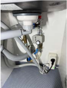
Røropplegg i kjøkkenbenk UNDERETASJE 1 > KJØKKEN
