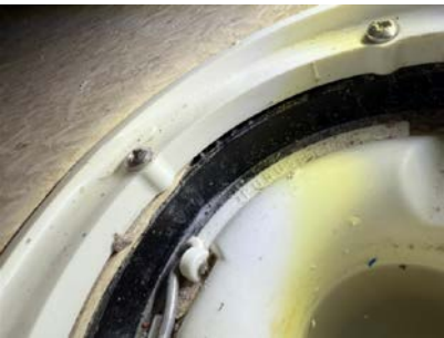
Vinylbeleggets avslutning rundt klemring er ikke fullstendig synlig rundt hele
