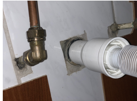
Mangler membranmansjett på rør
