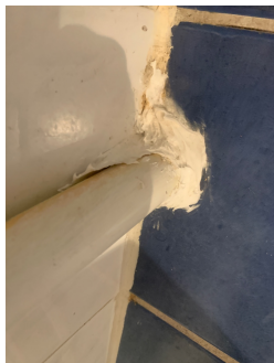
Mangler membranmansjett på rør
