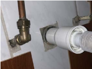
Mangler membranmansjett på rør
