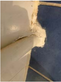
Mangler membranmansjett på rør
