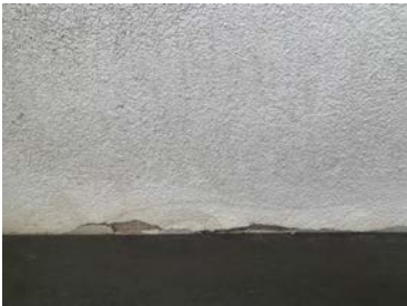
Litt pussavflassing på en av veggene
