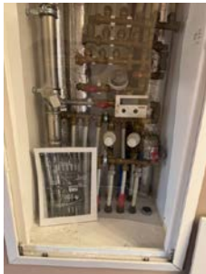
Rørskap i gangen med stoppekraner.
