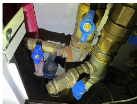
Mindre korrosjon ved den ene koblingen
