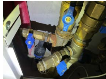
Mindre korrosjon ved den ene koblingen
