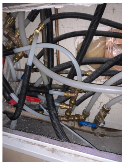
Røranlegg med adkomst fra luke i bad. Bildet viser rør irør vannrør og noen kobberrør. Stoppekraner for utevann
