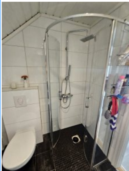
TG 1 7.1.2 Overflate gulv
