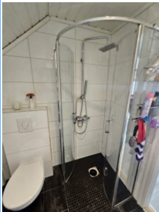
TG 1 7.1.2 Overflate gulv
