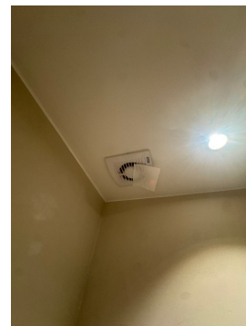
Test av avtrekk. Papiret henger.
