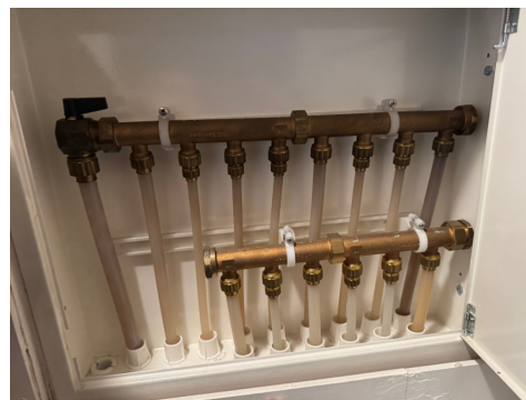
Rørskap med samlestocker og stoppekranner.
