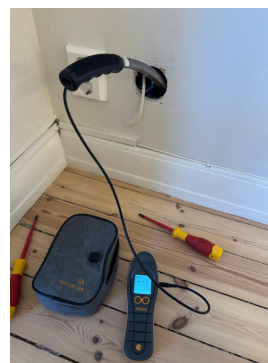
Fuktmåling i hulrom i vegg bak dusjen.
