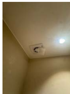
Test av avtrekk. Papiret henger.
