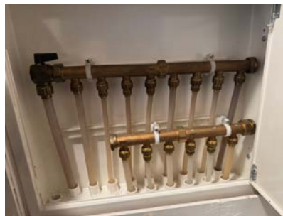
Rørskap med samlestocker og stoppekraner.
