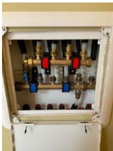
Fordelerskap med stoppekraner soverom.
