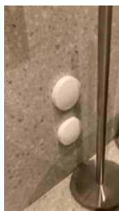
Kopper for lekkasjevann fra rørskap og blandebeaterier
