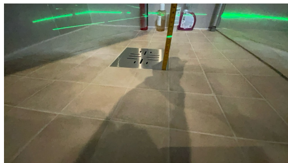
Høydeforskjell (ved sluk)
