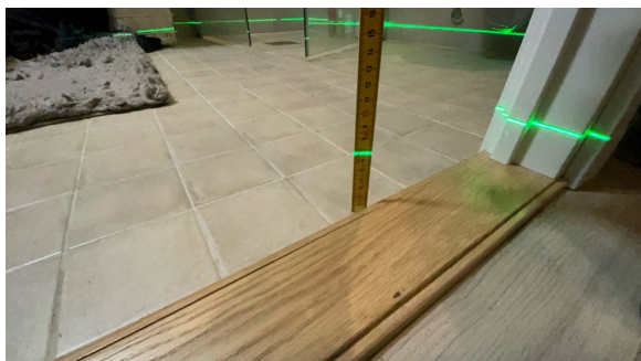
Høydeforskjell (flis ved terskel)
