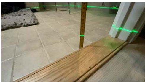
Høydeforskjell (flis ved terskel)
