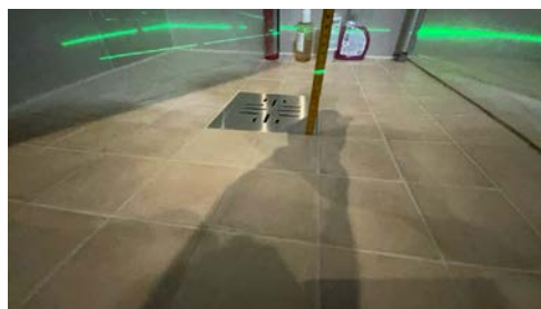
Høydeforskjell (ved sluk)
