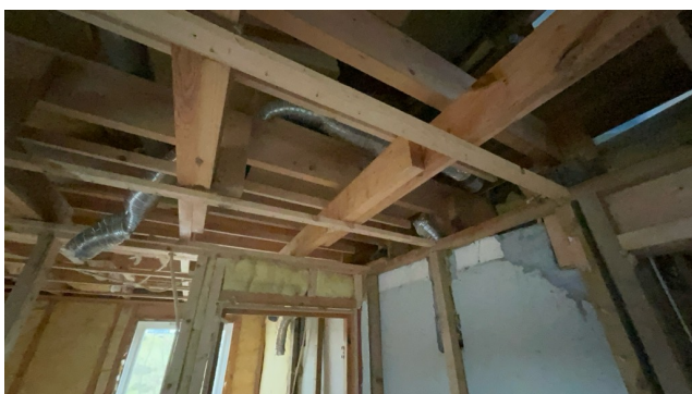
Lufterør avsluttet på loftet.
