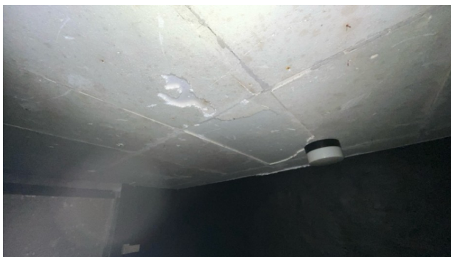
Ikke tildekket isopor i garasje
