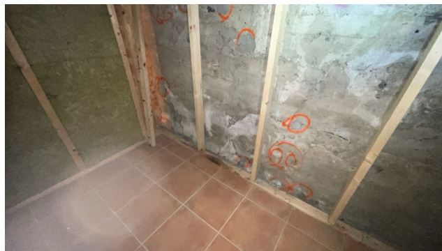
Fukt/saltutslag i kjeller
