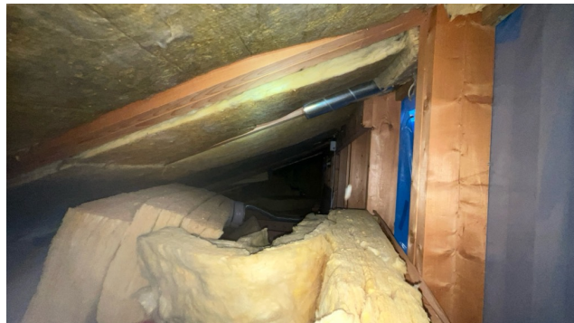
Isolasjonene er ikke montert på plass igjen
