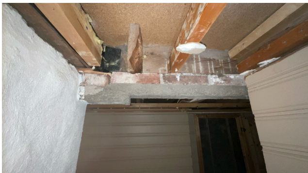
Svak understøttelse av bjelkelaget
