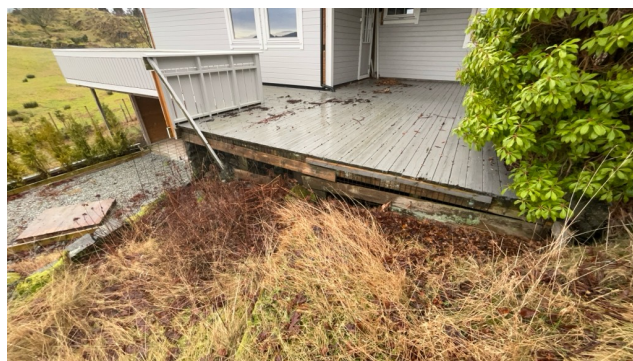
Ikke montert rekkverk.
