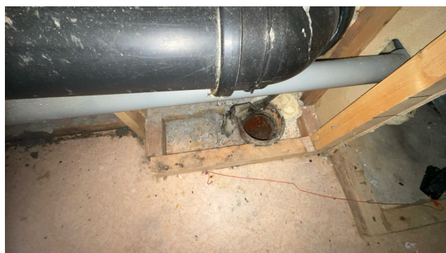
Åpent avløpsrør i gulvet.
