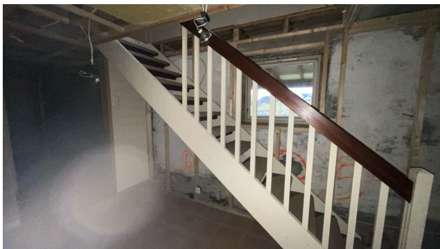
Det mangler litt rekkverk
