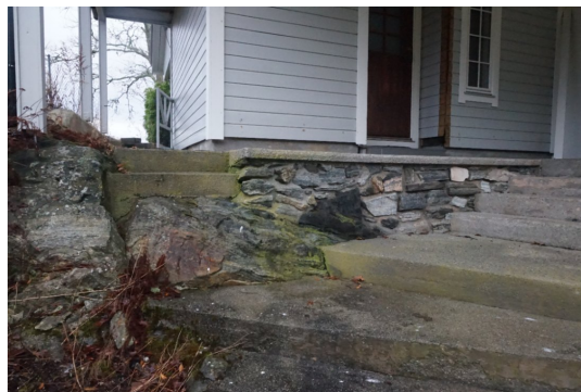
Ikke rekkverk på forstøtningsmur
