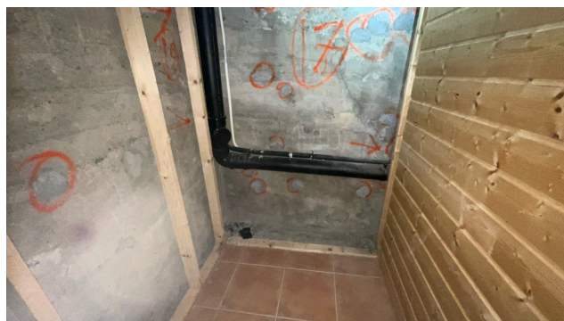
Fukt/saltutslag i kjeller
