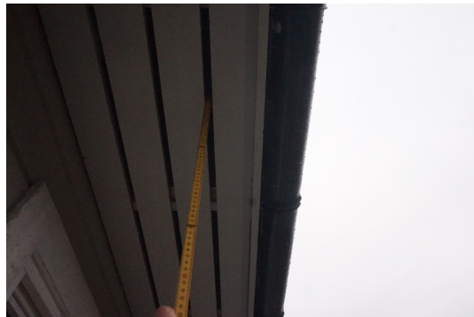
Ikke montert insekts netting
