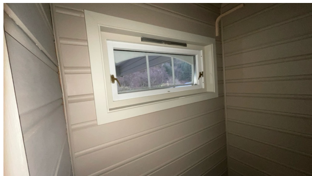
Luftespalte i vinduskarm.
