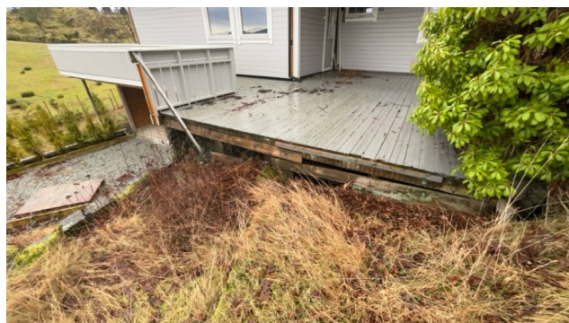
Ikke rekkverk på terrasse
