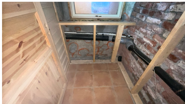
Fukt/saltutslag i kjeller
