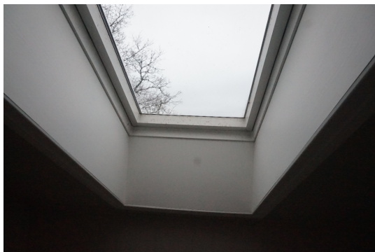
Svarte merker i vinduskarmen
