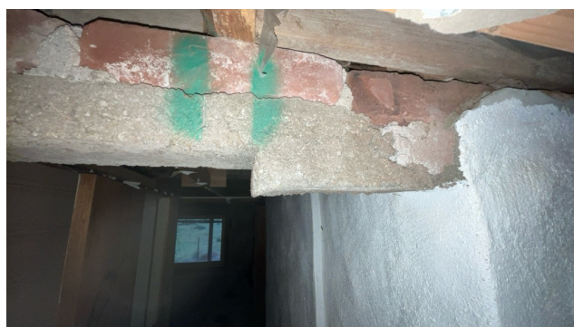
Svak understøttelse av bjelkelaget
