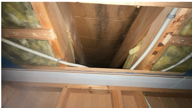
Fukt/kondensmerker på Brettex plater
