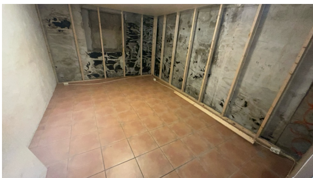
Fukt på vegger i kjeller
