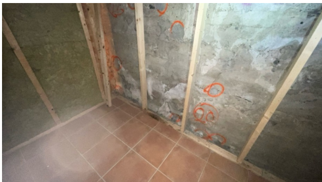
Fuktinntrengning gjennom grunnmur
