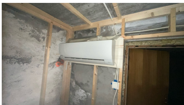
Varmepumpe i kjeller
