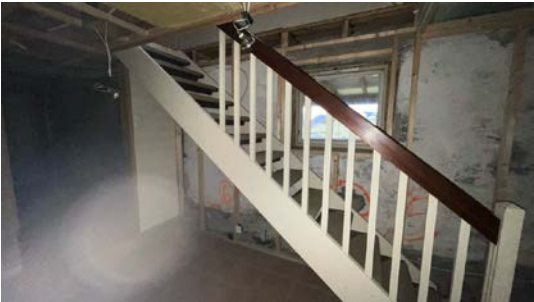
Det mangler litt rekkverk
