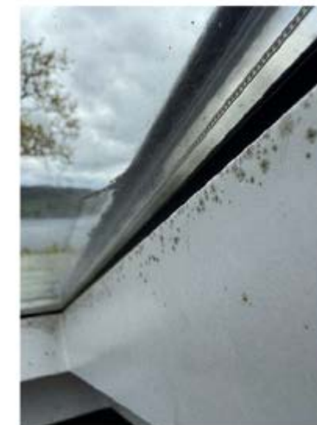
Dette vurderes som nyere, og skyldes kombinasjon av flere feil i huset.
