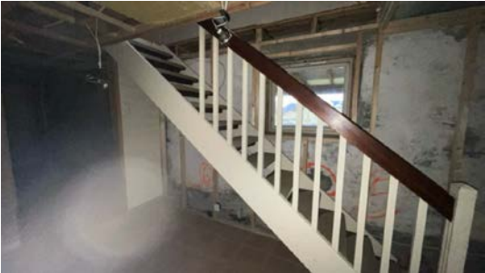
Åpning i rekkverket
