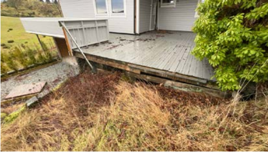
Ikke montert rekkverk.
