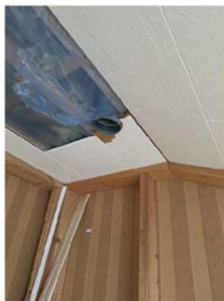
Ventilasjon i himling er ført ned skråhimling til kneloft.
