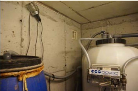
Ventil i yttervegg
