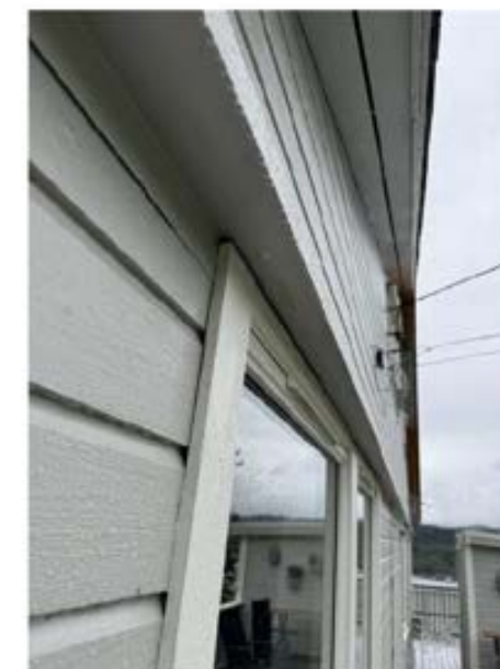
Yttervegger med TG1, info om lufting. Her ses det ikke lufting av kledning.
