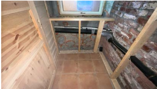
Fukt/saltutslag i kjeller
