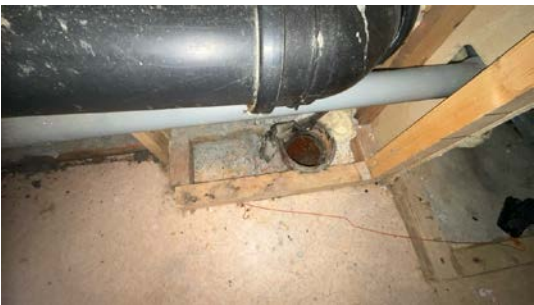
Åpent avløpsrør i gulvet.
