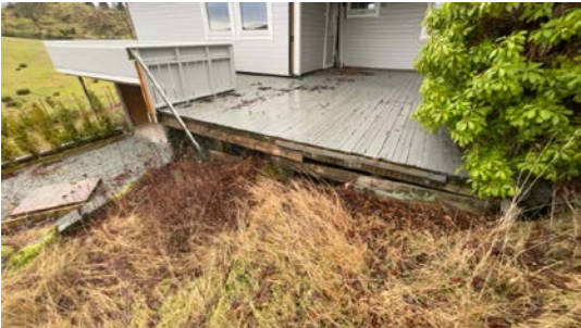
Ikke rekkverk på terrasse
