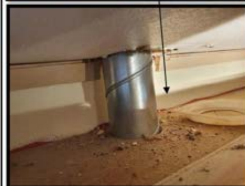
Det ble funnet museavføring oppå kjøkkenskap vet ventilator.
