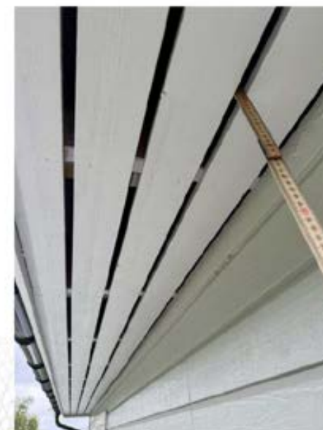
Mangler fuglesikring i kiste.
