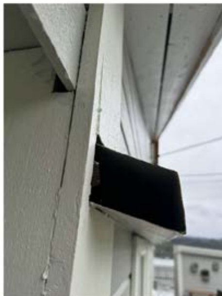
Stor åpning i beslag, mangler sluttstykke som hindrer bla- fugler tilkomst.
