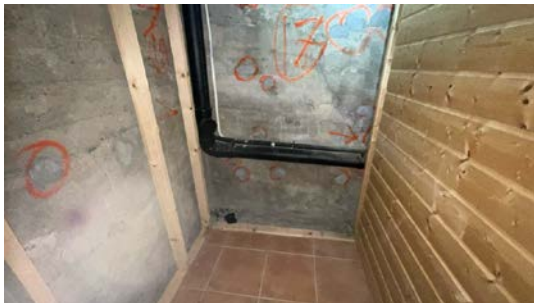
Fukt/saltutslag i kjeller
