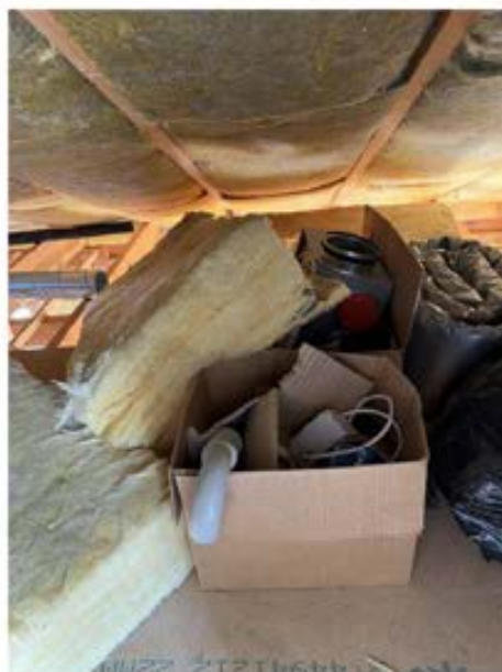
Ventilasjonsanlegget er lagret i pappesker på loft fra selges eiertid.
