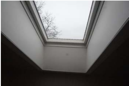
Svarte merker i vinduskarmen
