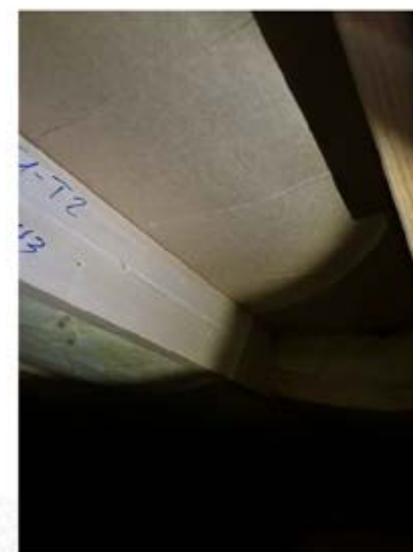
Isolasjon og sutak med misfarge, sutak med muggsopper
