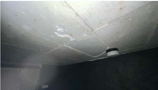
Ikke tildekket isopor i garasje
