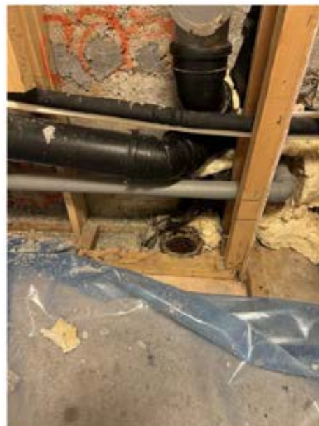
Åpent støpejerns rør har vært skjult bak vegg.
