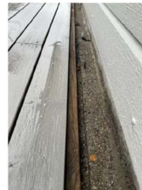
Mangler beslag som leder vann vekk fra underliggende kjeller. Tiltak mot fuktinnsig er nødvendig for å sikre forholdet.
