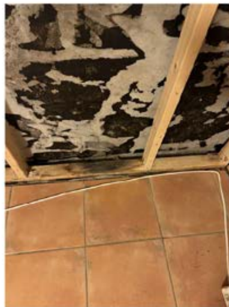
Tegn til fuktnissig over tid.
