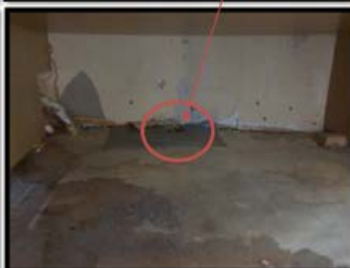
Viser hull i gulvet hvor mus antagelig har kommet opp fra etasjeskillet.
