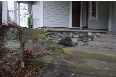
Ikke rekkverk på forstøtningsmur
