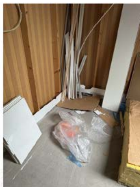
Isopor montert for dekket er ikke tildekket og ikke observert og vurdert i TR.
