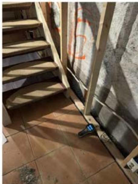
Tilfeldig måling av svill ved trapp.
