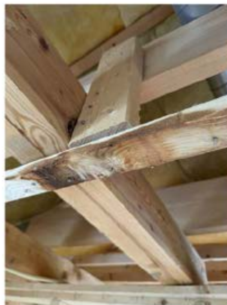
I areal for kjøkken er det tegn til urin i trevirke i et skille mot loft.
