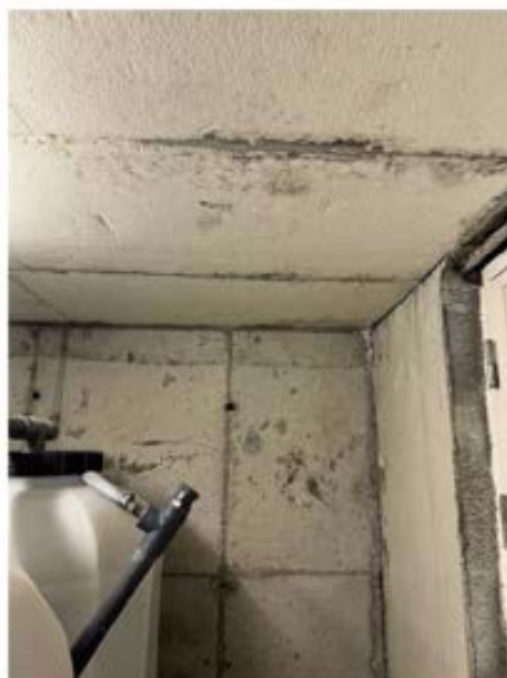
Isopor som er synlig må tildekkes med ubrennbare materialer, bilde fra rom med Biovac.
