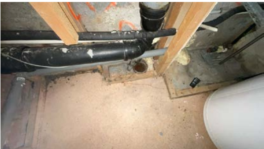
Åpent avløpsrør i gulvet.
