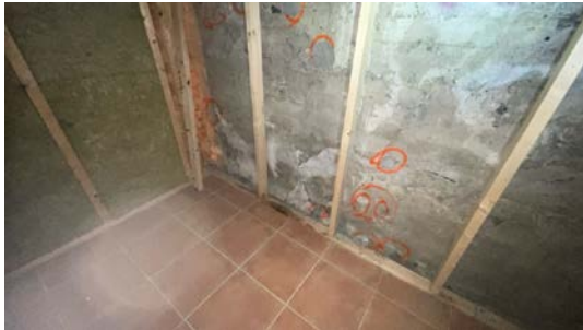
Fukt/saltutslag i kjeller
