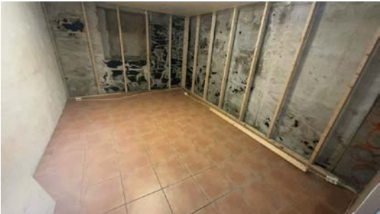
Fukt på vegger i kjeller
