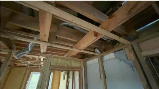
Lufterør avsluttet på loftet.
