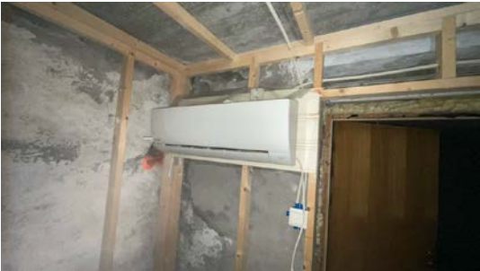
Varmepumpe i kjeller
