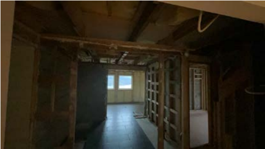
Veggplatene og himlingsplater er fjernet i flere rom
