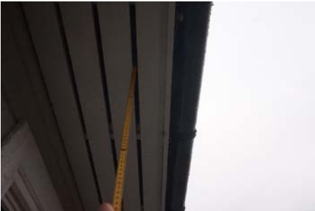
Ikke montert insekts netting
