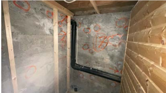
Yttervegger, merket der det har vert tettet hull.
