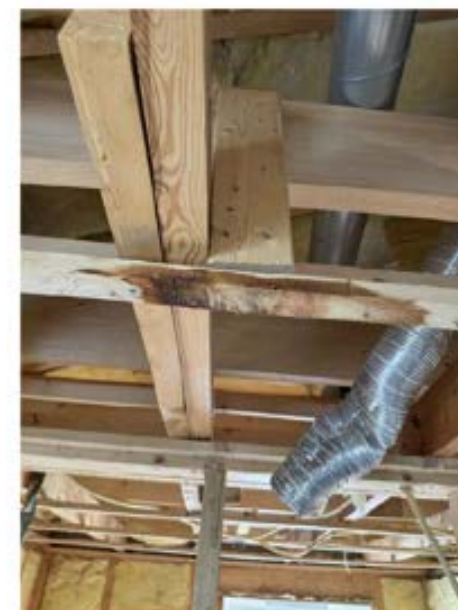
Ventilasjon fra 1.et. til kneloft. Her ses også kanal som ligger lagret på kneloft.
