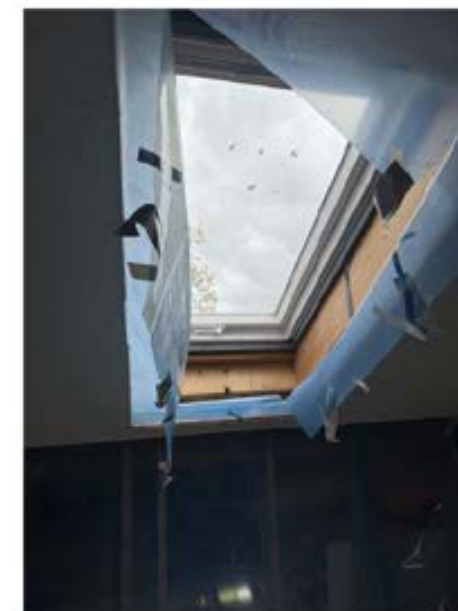
Bilde fra bad: Alle Velux-vinduer i loftsetasjen har synlig muggvekst i karmområdet.
