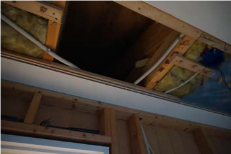
Ikke isolert himling.
