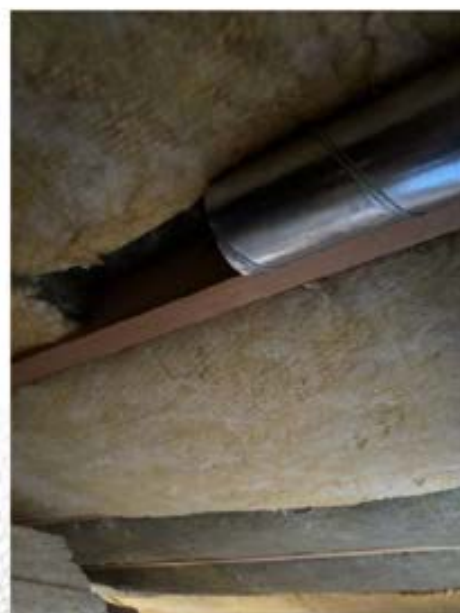
Avsluttet ventilasjon inn mot isolasjon på kneloft.
