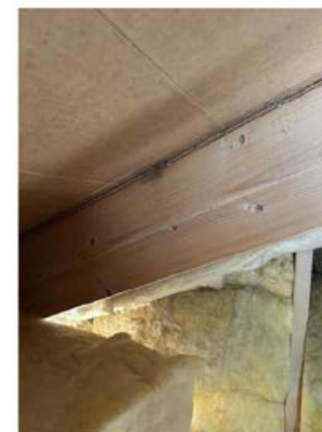
Prøve nr.1: Prøvene viser muggsoppforekomst på alle testede områder i undertaket. Dette bekrefter skjult vekst, også der det ikke var klart synlige tegn ved inspeksjon.
