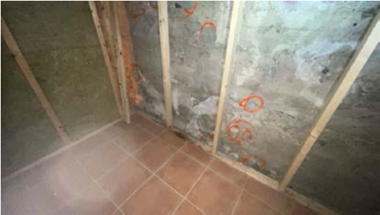
Fuktinntrengning gjennom grunnmur
