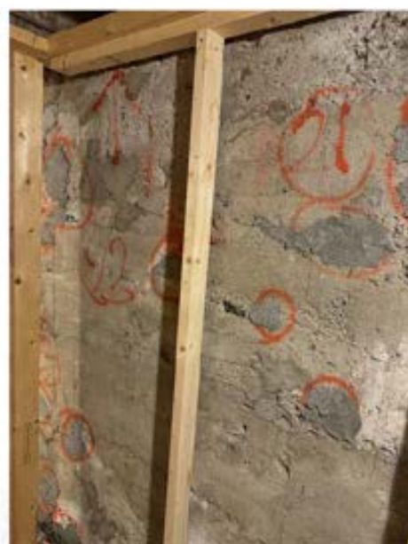
Flere eldre tettingsarbeid.
