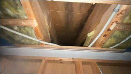
Fukt/kondensmerker på Brettex plater
