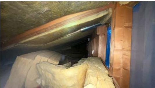
Isolasjonene er ikke montert på plass igjen
