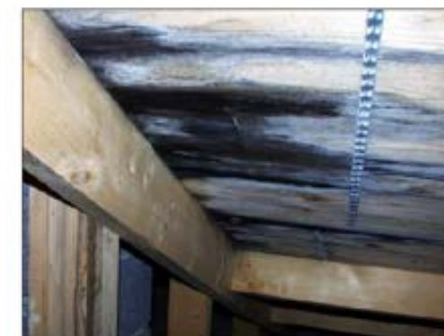
Misfarging av innvendig takbord forårsaket av fargeskadesopp.
