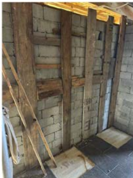
Eldre trevirke tilført kjøkken opplegg, påvist med muggsopper.
