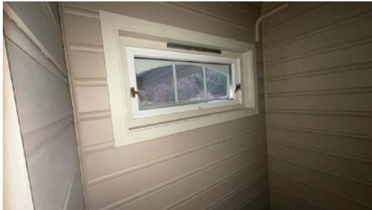
Luftespalte i vinduskarm.
