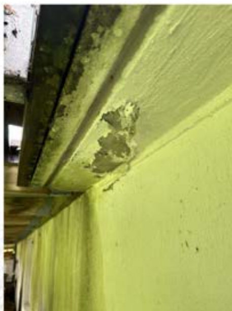
Avskalling grunnet saltutslag. Tiltak mot fuktinnsig er nødvendig for å sikre forholdet.
