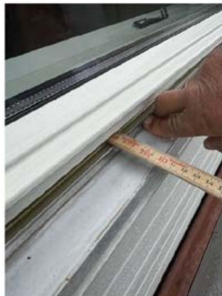
Vinduer med TG1. Men er med åpning i beslag.
