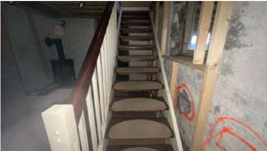
Ikke montert håndlist.
