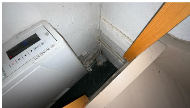
Stedvis behov for lokale utbedringer.
