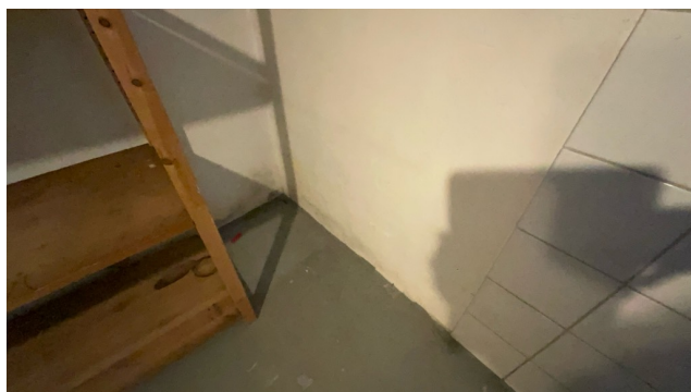
Stedvis behov for lokale utbedringer.
