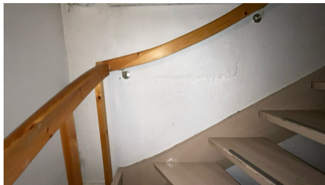
Stedvis behov for lokale utbedringer.
