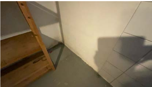
Stedvis behov for lokale utbedringer.
