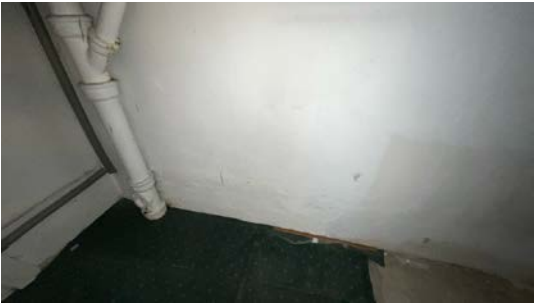
Stedvis behov for lokale utbedringer.
