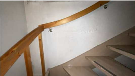
Stedvis behov for lokale utbedringer.
