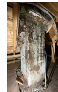
Synlig tegn til at pipeløp svetter ved fyring og er noe utett.
