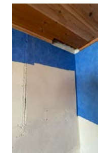
Tapet over pipeløp bør fjernes.
