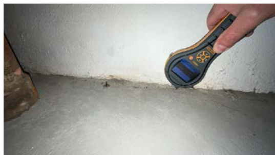
Påvist variable fuktverdier på nedre del av grunnmur.
