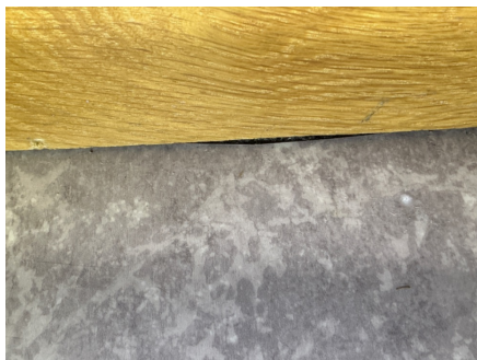
Synlig manglende oppbrett bak terskel
