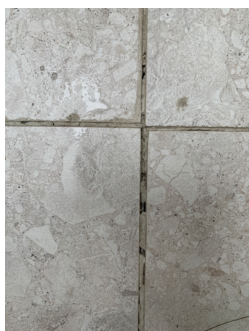
Løse fuger og stort sett flisbom på hele gulvet
