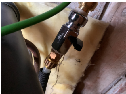
Stoppekran for kjøkken i luke i hovedsoverom
