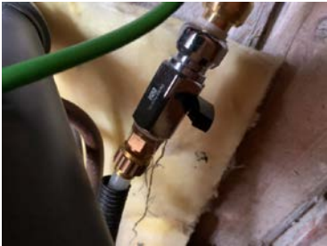
Stoppekran for kjøkken i luke i hovedsoverom
