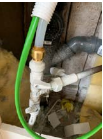
Stoppekraner for kjøkken i luke i hovedsoverom
