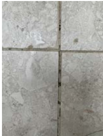
Løse fuger og stort sett flisbom på hele gulvet
