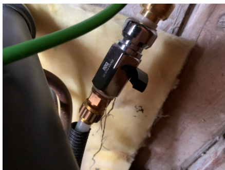
Stoppekran for kjøkken i luke i hovedsoverom
