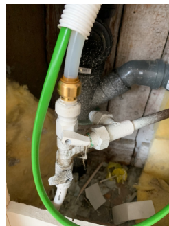
Stoppekraner for kjøkken i luke i hovedsoverom
