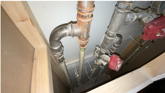
fjernvarme i huset
