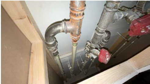
fjernvarme i huset
