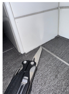
Ikke tilfredsstillende dreneråpning.
