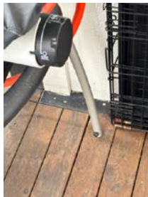
Liten avstand mellom kledning og beslag.
