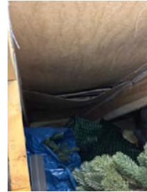
Nedbøyning i su-tak/undertaksplate.
