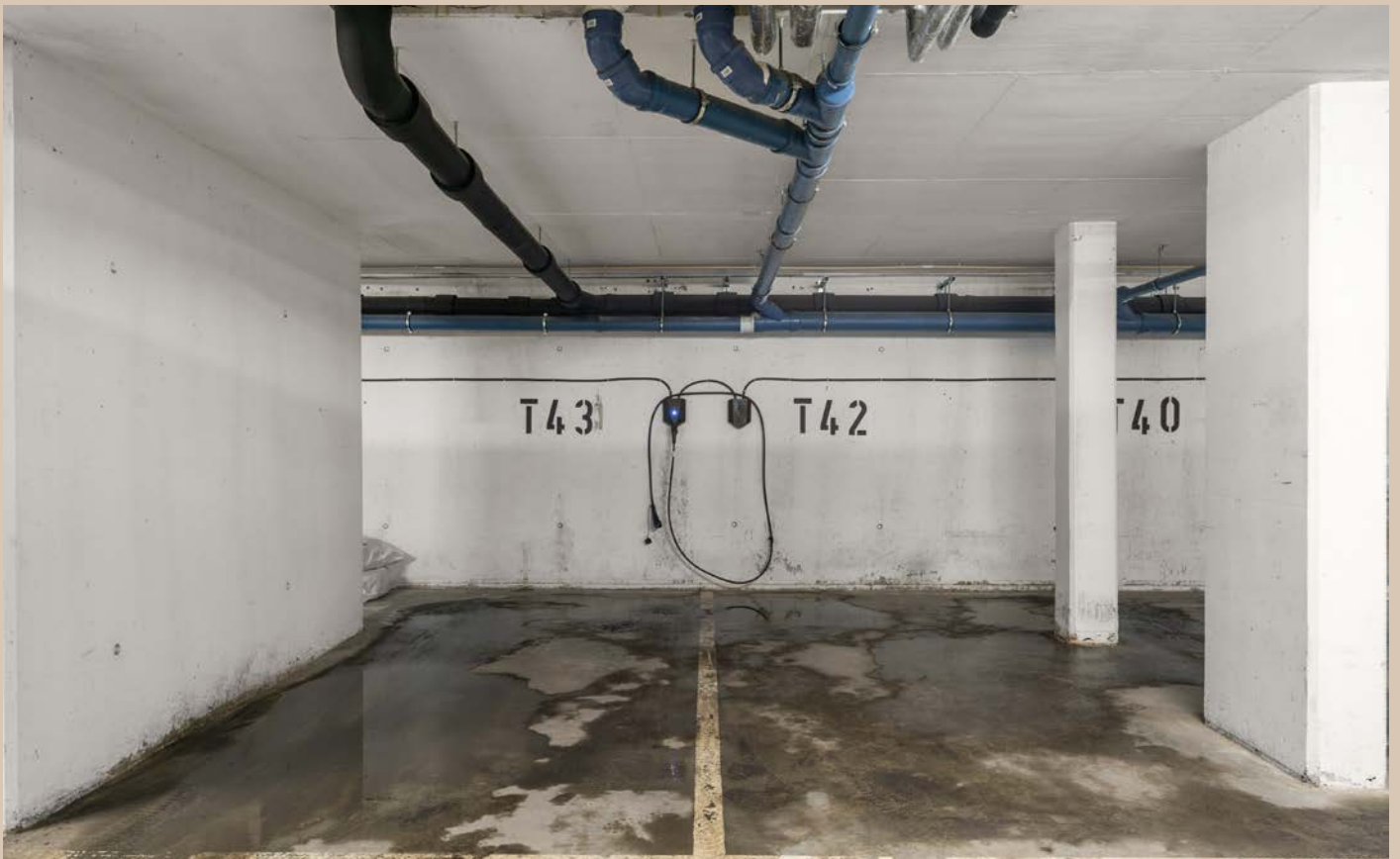
Det disponeres egen parkeringsplass i garaskjeller
