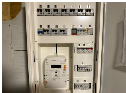
Sikringskap i teknisk rom
