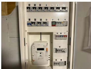
Sikringsskap i teknisk rom
