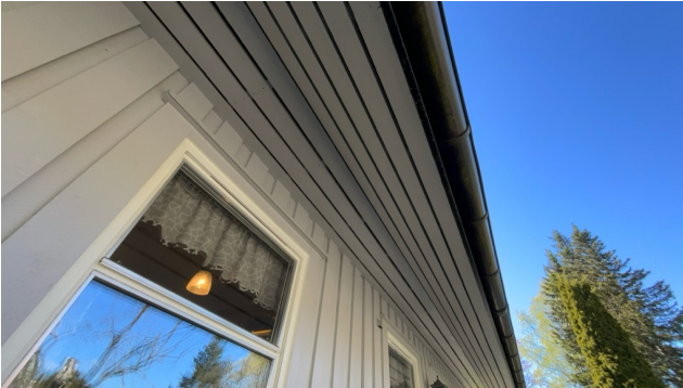
Synlige luftespalter i gesimskasse.
