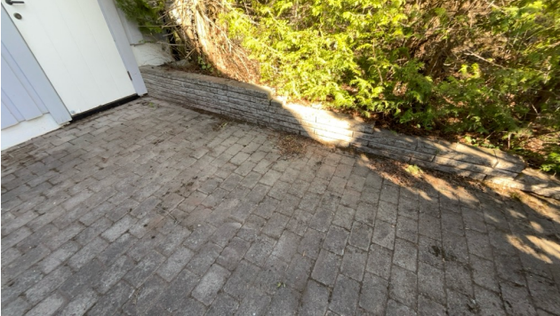
Besiktigelse av støttemur. Konstruksjonene har skjevheter.
