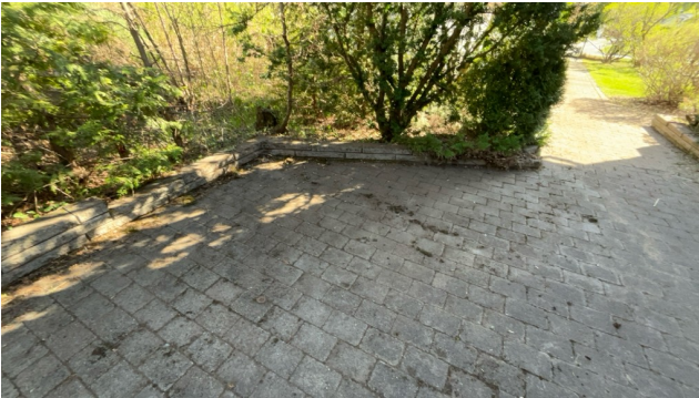
Besiktigelse av støttemur. Konstruksjonene har skjevheter.
