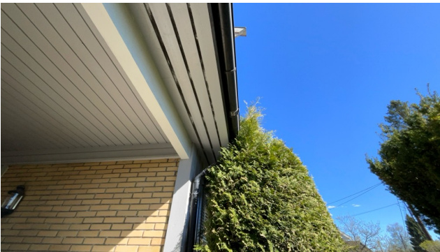
Synlige luftespalter i gesimskasse.
