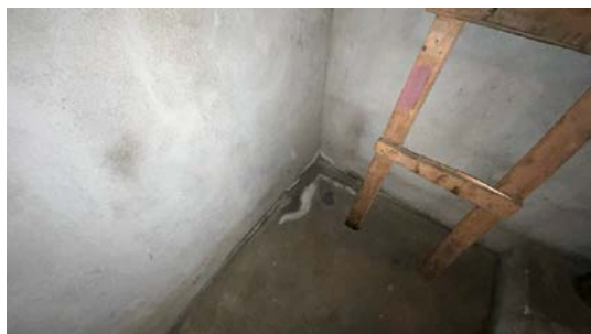
Synlige fukt flekker i kjeller.
