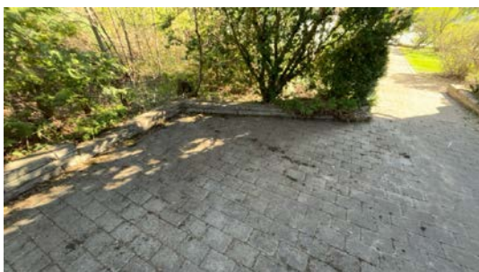
Besiktigelse av støttemur. Konstruksjonene har skjevheter.
