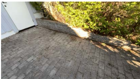
Besiktigelse av støttemur. Konstruksjonene har skjevheter.
