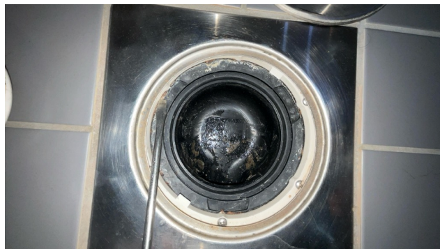
Plastsluk i gulv.
