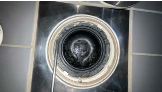
Plastsluk i gulv.
