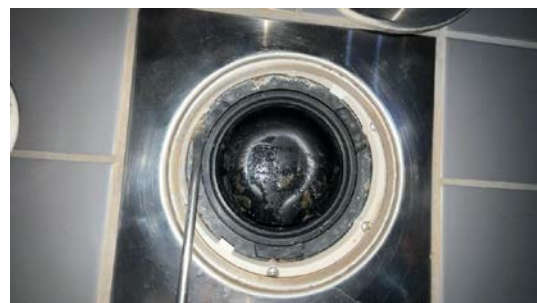
Plastsluk i gulv.
