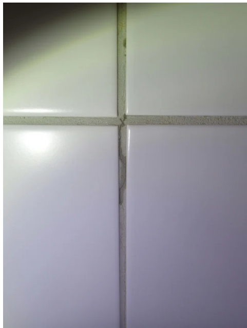
Det registreres riss/ sprekker i flisefuger på vegg i dusjonen.
