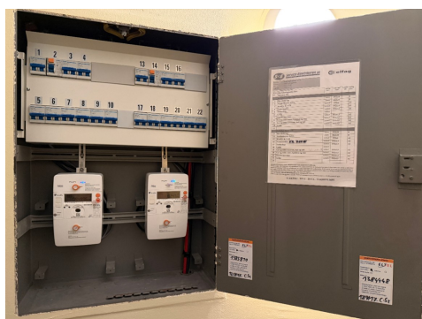
Sikringsskap i fellesarealer.
