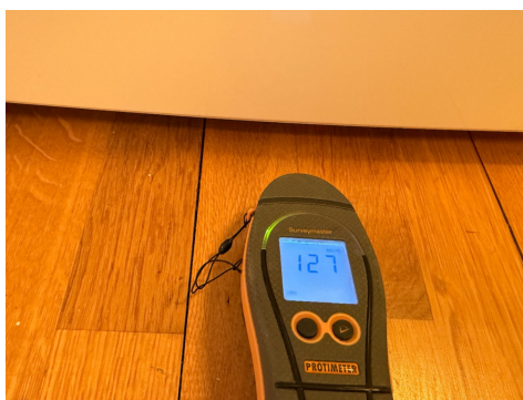
Fuktskade i parkett v/ kjøleskap plass. Ingen forhøyede fuktverdier ble registrert i det aktuelle område på befaringsdagen.
