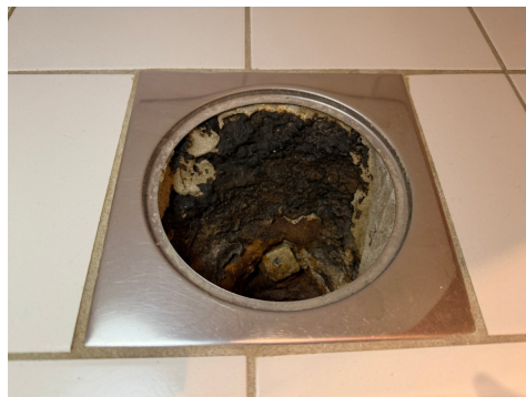
Eldre støpejernsluk i gulv under baderomsinnredning.
