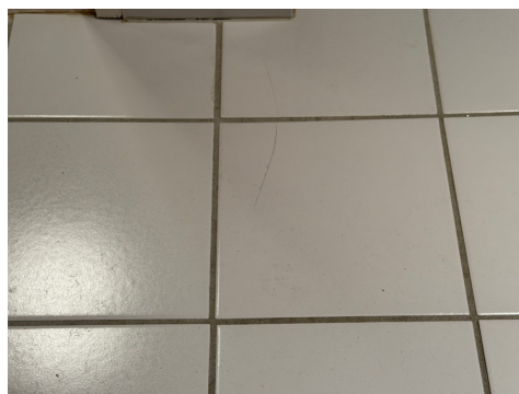
Sprekk i gulvfliser v/ dør.
