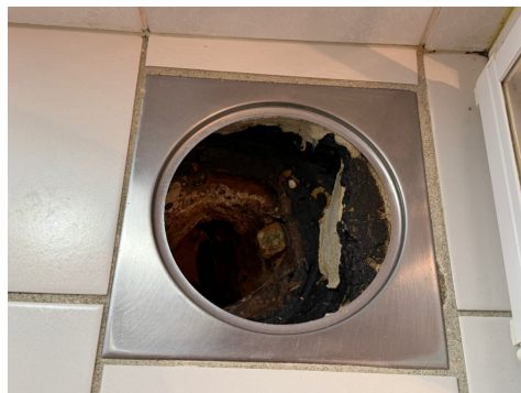
Eldre støpejernsluk i dusjsone.
