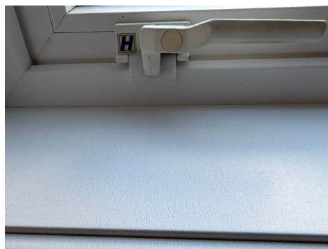
Riss/krakelering i vindustilsetning på hovedsoverom.
