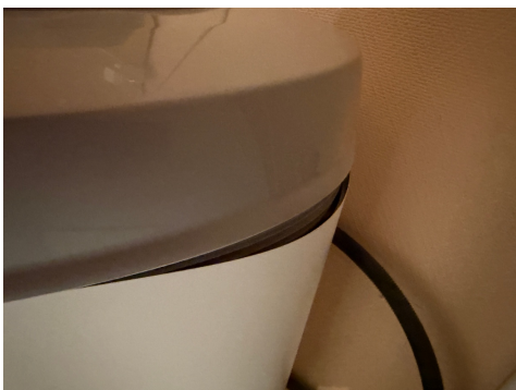
Bul i deksel rundt varmtvannstank.
