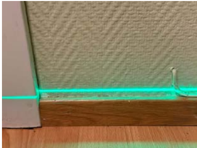
Bilder viser skjevheter i gulv i entre/gang.
