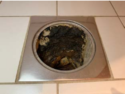
Eldre støpejernsluk i gulv under baderomsinnredning.
