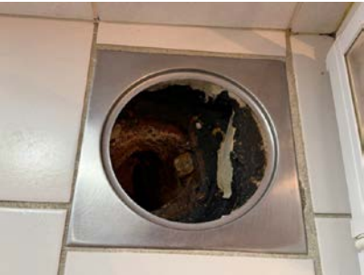
Eldre støpejernsluk i dusjsone.
