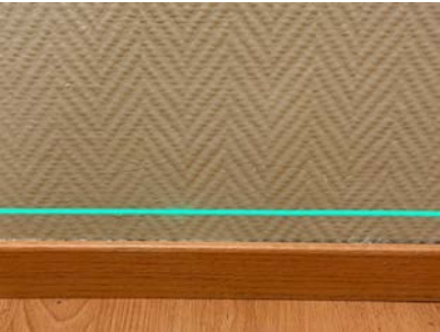
Bilder viser skjevheter i gulv i entre/gang.
