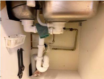
Rørøpplagg under vask.
