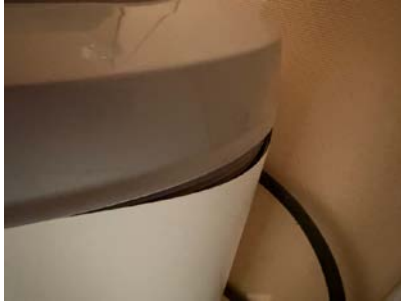
Bul i deksel rundt varmtvannstank.
