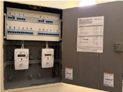
Sikringsskap i fellesarealer.
