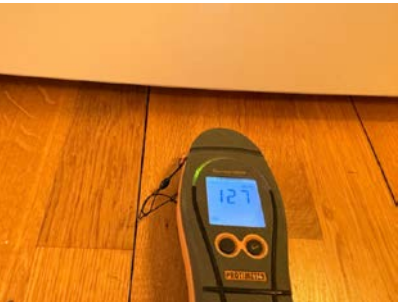
Fuktskade i parkett v/ kjøleskap plass. Ingen forhøyede fuktverdier ble registrert i det aktuelle område på befaringsdagen.
