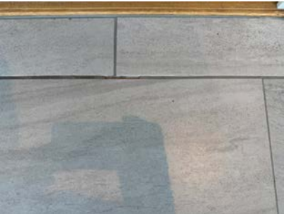
Delvis oppsprukket fuge mellom gulvfliser pga. bevegelse i flis.
