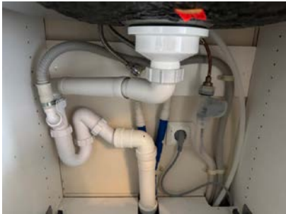
Røropplegg under vask. 2-ETG > STUE/KJØKKEN (36,1 M²)
