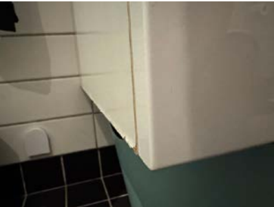
Fuktutsvelling i nedre del av baderomsinnredning.
