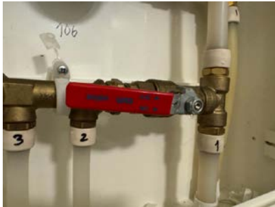
Stoppekran i rør i rør skap.
