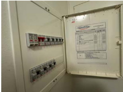
Sikringsskap i bod/teknisk rom.
