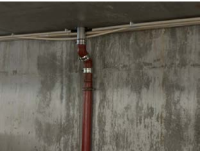
Ma støpejernsrør i garasjeanlegg.
