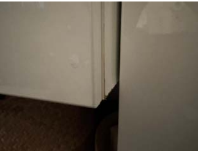
Fuktutsvelling i nedre del av baderomsinnredning.
