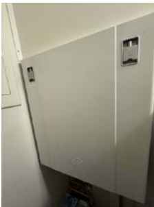
Luftbehandlingsaggregat i bod/teknisk rom.
