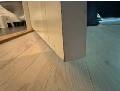
Fuktutsvelling/slitasje i nedre del av badedør.
