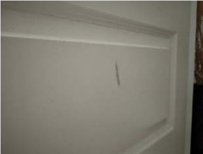
Sår/mindre skade på innside av toalettromdør.
