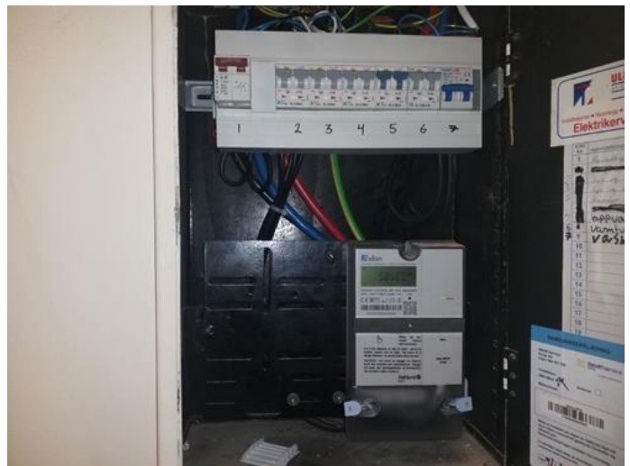
Elektrisk anlegg - [Sikringskap. ]
