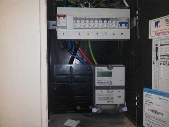
Elektrisk anlegg - [Sikringskap. ]
