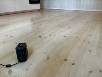
Nivellering stue/kjøkken, avvik ca. 10-20 mm.
