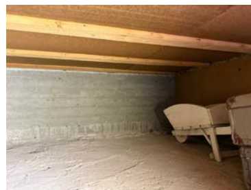
En må krype i blindkjelleren.
