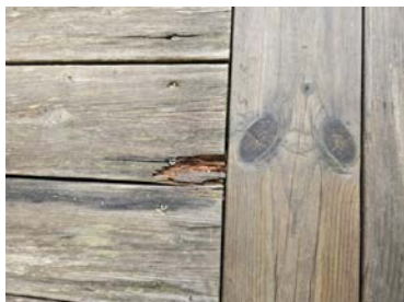
Råteskade i terrassebord.
