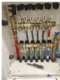
Kontroll av fordelerskap for vannbåren gulv varme.
