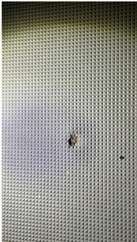
Eksempelbilde av skruenhull/ brudd i tettesjikt.
